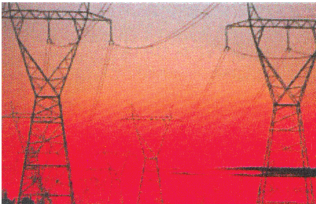
Εικ. 5.7 Η ηλεκτρική ενέργεια μεταφέρεται από τα εργοστάσια παραγωγής στην κατανάλωση με αγωγούς μεταφοράς υπό υψηλή τάση.
