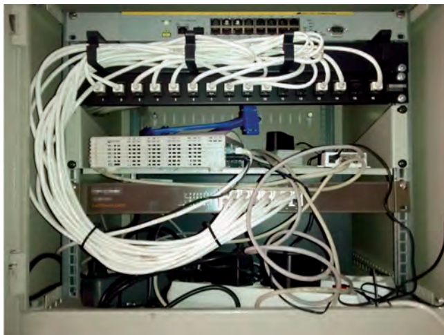
Εικόνα 151: Rack σχολικού εργαστηρίου με Switch & Patch-panel.
