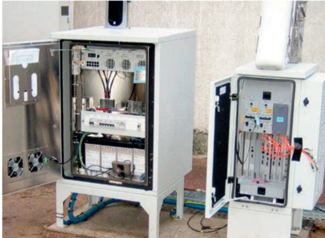
Εικόνα 198. Εξοπλισμός βάσης δικτύων τέταρτης γενιάς 4G. By Groupe Aménagement Numérique des Territoires, https://upload.wikimedia.org/wikipedia/commons/d/d2/WiMAX_equipment.jpg
