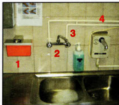
Εικ. 4.10. Χώρος πλυσίματος χεριών σε εργαστήριο επεμβατικής ακτινολογίας. Διακρίνονται αντλίες απλού σαπουνιού (1) κι αντισηπτικού (2), απλή βρύση (3) βρύση με αυτόματο σύστημα (4)
