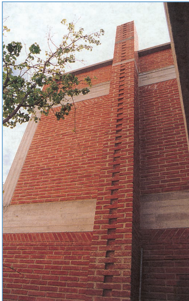
62. Τοίχος από τούβλο εμφανές. Διακρίνεται ο σκελετός από μπετόν αρμέ. Κατοικία στη Φιλοθέη, Αθήνα.
