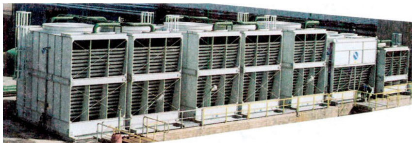
Σχήμα 8-73: Συγκρότημα πύργων ψύξης εγκατάστασης βιομηχανικού κλιματισμού.
