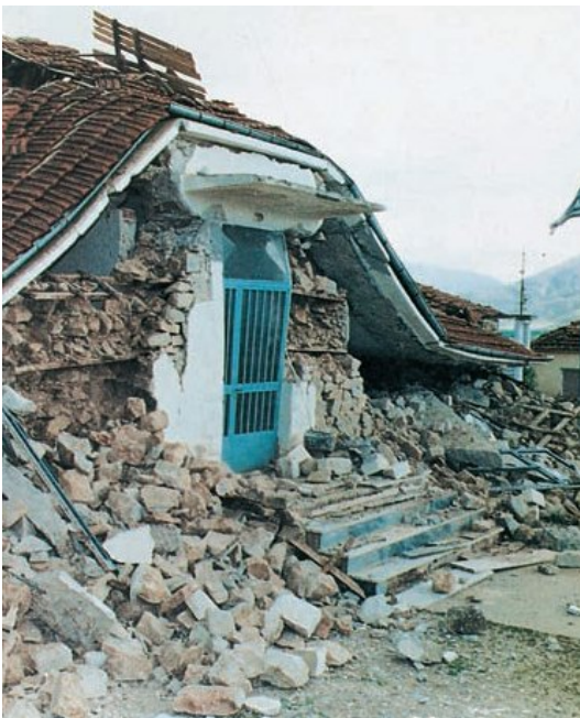
Εικόνα 27.1α: Καταστροφή από σεισμό
