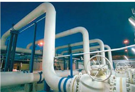
Εικόνα 39.2: Εργοστάσιο Δ.Ε.Π.Α (ΔΗΜΟΣΙΑ ΕΠΙΧΕΙΡΗΣΗ ΑΕΡΙΟΥ)
