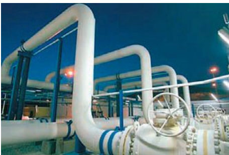
Εικόνα 39.2: Εργοστάσιο Δ.Ε.Π.Α (ΔΗΜΟΣΙΑ ΕΠΙΧΕΙΡΗΣΗ ΑΕΡΙΟΥ)
