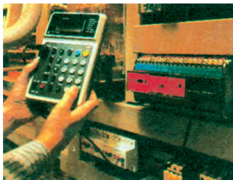
Σχήμα 9: Έλεγχος βλαβών σε εγκατάσταση αυτοματισμού με PLC.
