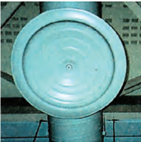
Κυκλικό στόμιο οροφής
