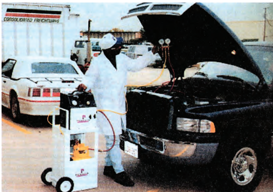
Εικόνα 6.2: Σύνδεση σελτ μανομέτρων στο σύστημα κλιματισμού.
