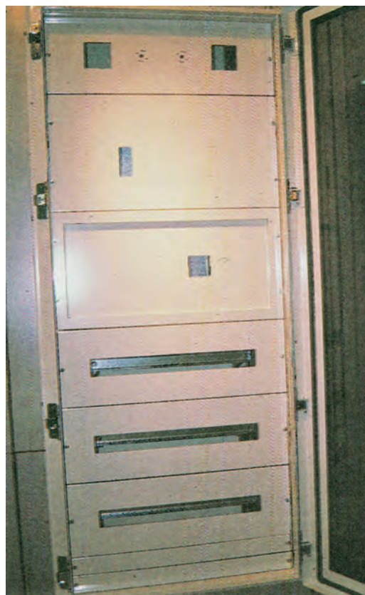
Μεταλλικό κιβώτιο πίνακα κίνησης
