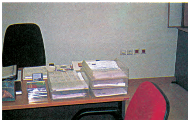
Χώρος εργασίας με εγκατάσταση δομημένης καλωδίωσης
