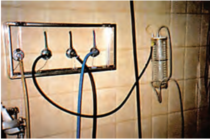
Εικ. 12γ. Επιτοίχιες σωληνώσεις αναισθητικών αερίων σε χειρουργείο με κεντρική εγκατάσταση χορήγησής των.
