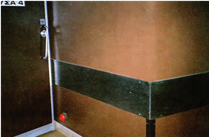
Εικ. 1. – Ανοξείδωτη μεταλλική επένδυση των τοίχων στο ύψος των φορείων και των γωνιών που εξέχουν. – Ποδοδιακόπτης για το άνοιγμα των χειρ/κών αιθουσών από «αποστειρωμένους» χρήστες.
