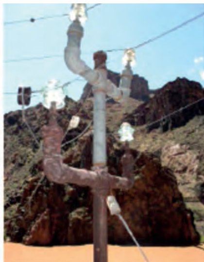
Εικόνα 5.1.α: Εγκατεστημένο τηλεφωνικό δίκτυο
