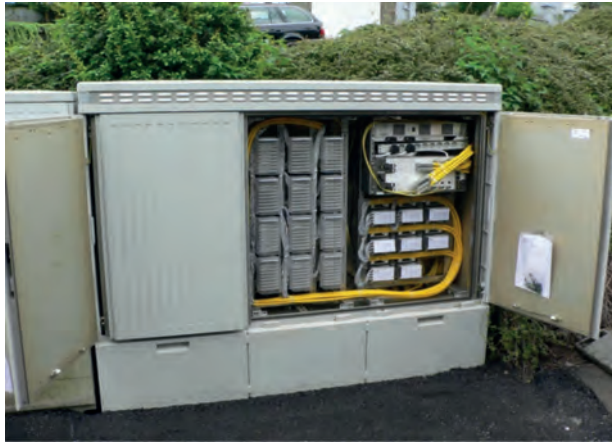
Εικόνα 5.1.4.1.β: Εξωτερικό DSLAM
