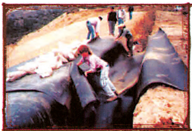
Εικόνα 100 Αυλάκωση και επίστρωση της επιφάνειας με στεγανωτικό υλικό
