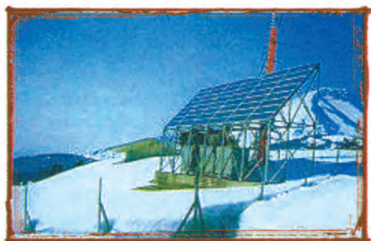
Εικόνα 118 Αυτόνομο Φ/Β σύστημα τηλεπικοινωνιών στο Όρος Δίρφη. [48]
