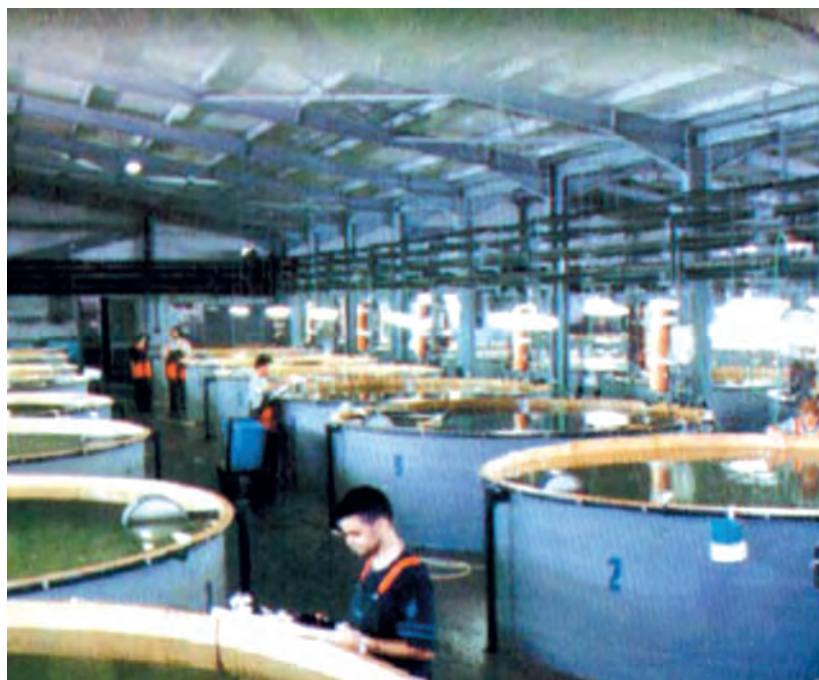
Εικόνα 8.3. Εσωτερικό ιχθυογεννητικού σταθμού.
