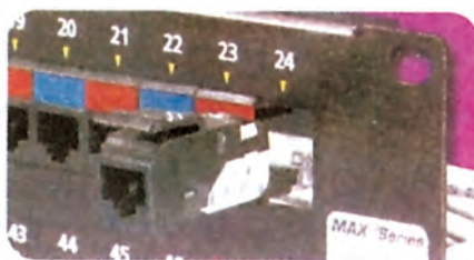
Εικόνα 5-7 Λεπτομέρεια κατανεμητή όπου φαίνεται ο IDC υποδοχέας
