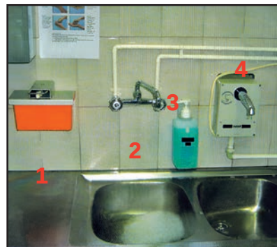
Εικ. 4.10. Χώρος πλυσίματος χεριών σε εργαστήριο επεμβατικής ακτινοβολίας. Διακρίνονται αντλίες απλού σαπουνιού (1) κι αντισηπτικού (2), απλή βρύση (3) βρύση με αυτόματο σύστημα (4)
