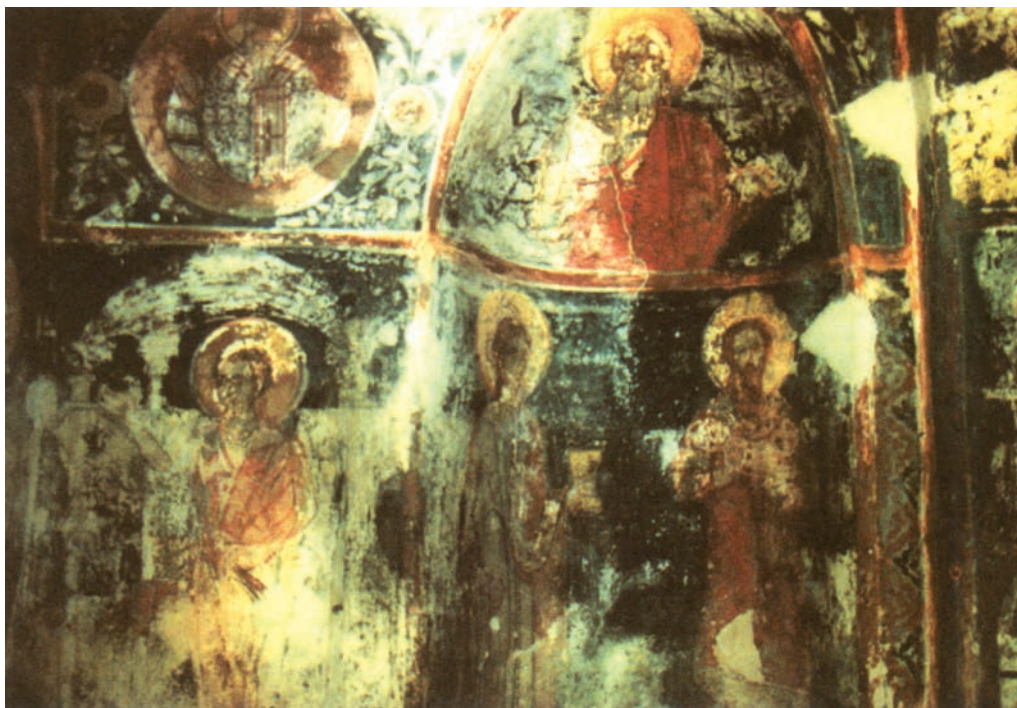
Φθορές τοιχογραφίας λόγω της επίδρασης της υγρασίας
