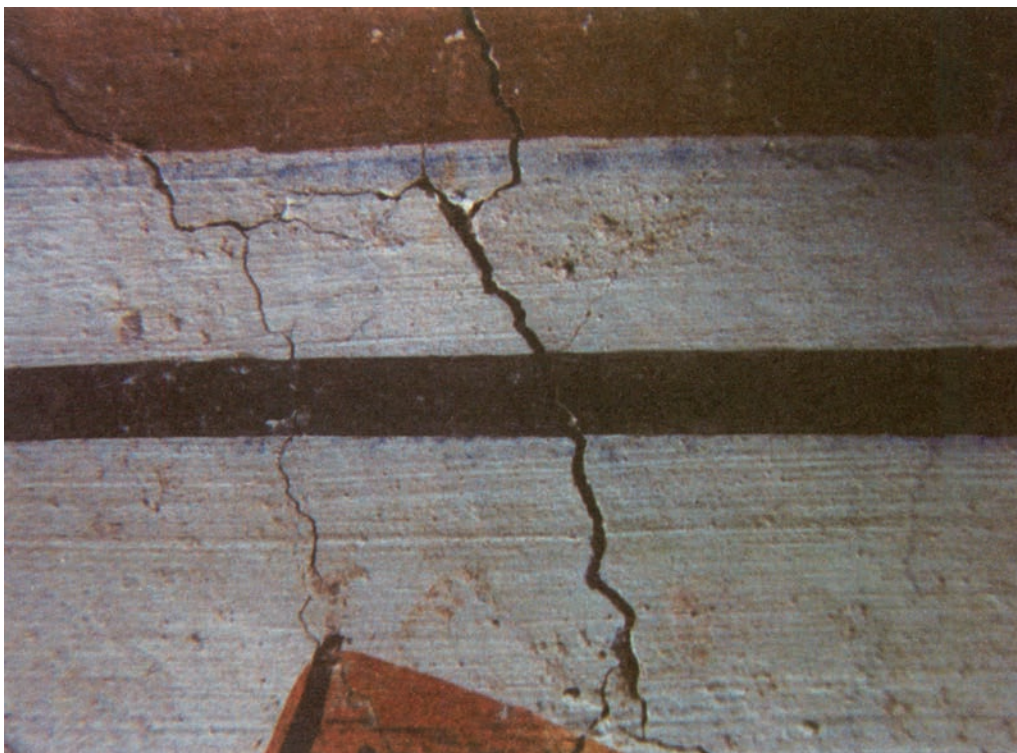
Λεπτομέρεια ρωγμής σε τοιχογραφία
