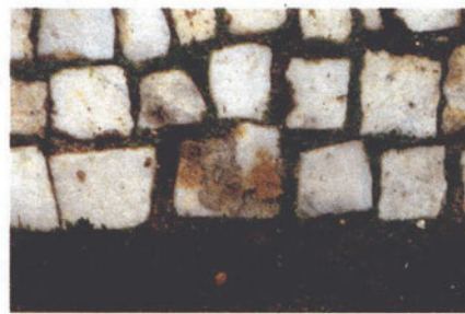
Διάβρωση των ψηφιδωτών από βρύα.
