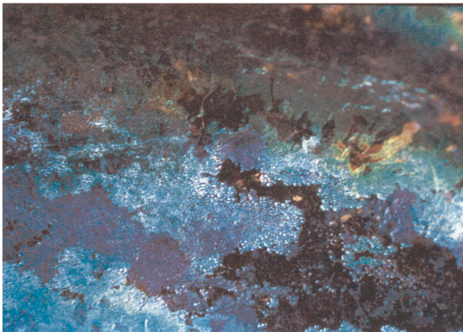
Διάβρωση επιφάνειας γυαλιού με φυλλώδη διάβρωση και με ιριδισμούς.
