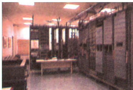
Εικ. 14. Εσωτερικός χώρος κατανεμητή
