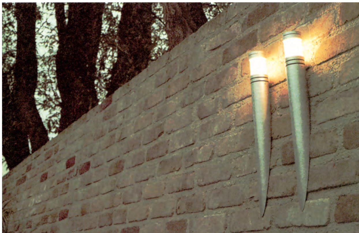
γ.41 Επιτοίχια φωτιστικά με διακοσμητικό φανοστάτη.
