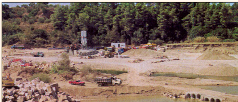
Σχήμα 2.9. Συγκρότημα παραγωγής σκυροδέματος
