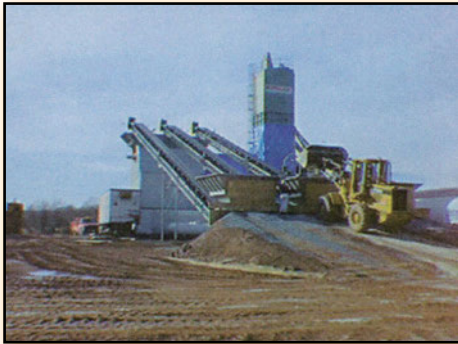
Σχήμα 3.14. Συγκρότημα παραγωγής σκυροδέματος
