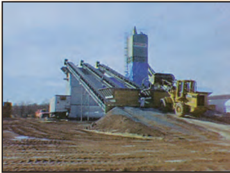
Σχήμα 3.14. Συγκρότημα παραγωγής σκυροδέματος
