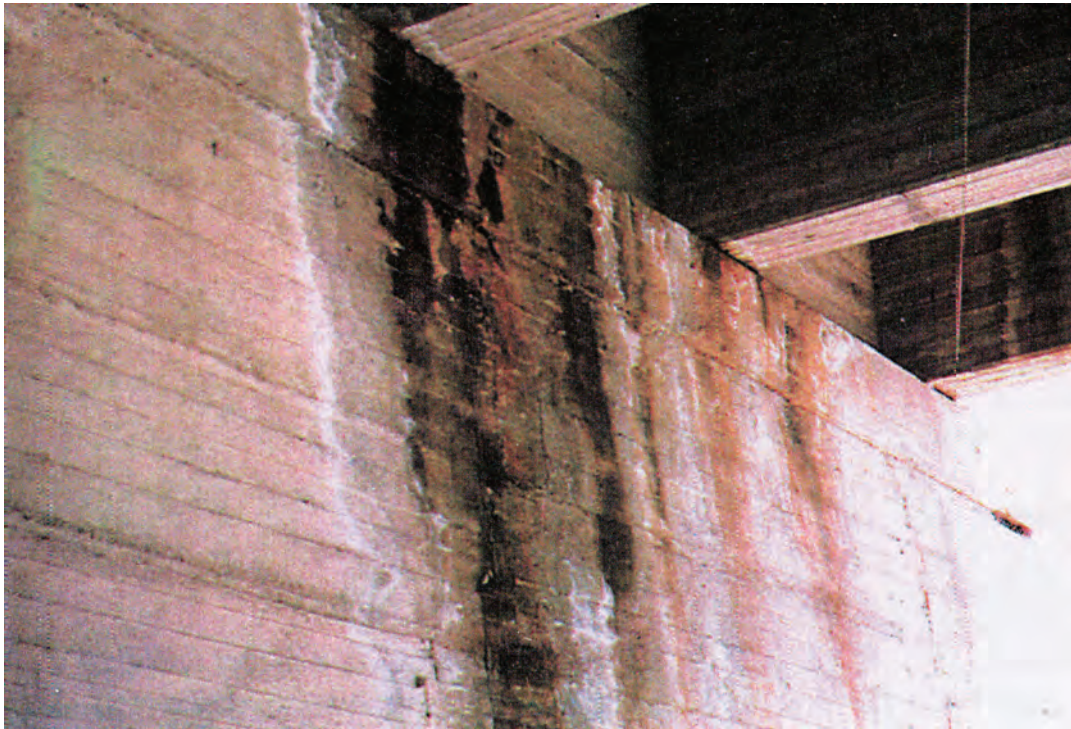
Σχήμα 2.2 Λεκέδες από άλατα κάτω από γέφυρα από σκυρόδεμα
