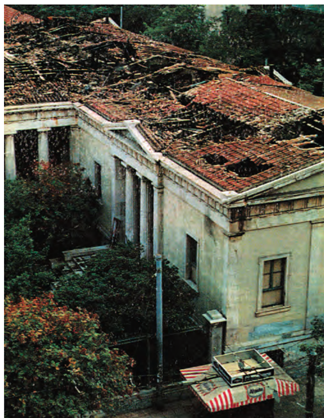
Σχήμα 12.7 Στέγη κατεστραμμένη από φωτιά
