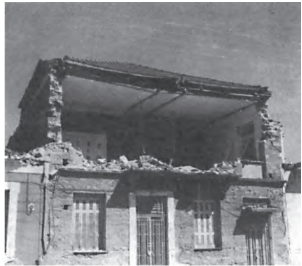
Φωτ. 11.6. Κατάρρευση τοίχου (Καλαμάτα 1986).
