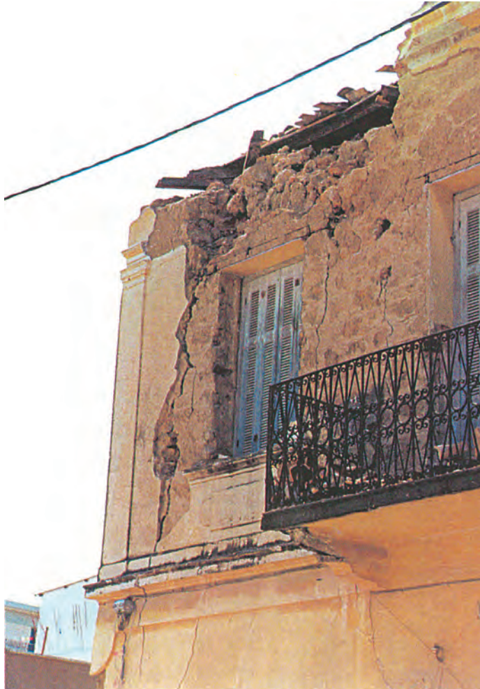
Φωτ. 8.5. Σεισμόπληκτο κτίριο.
