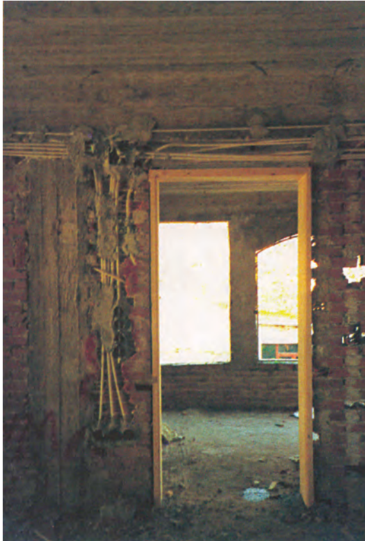
Φωτ. 11.3. Κακοτεχνίες σε οπτοπλινθοδομή.
