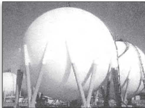
Εικόνα 7.1.2 Σφαίρα αποθήκευσης υγραερίου σε διυλιστήριο
