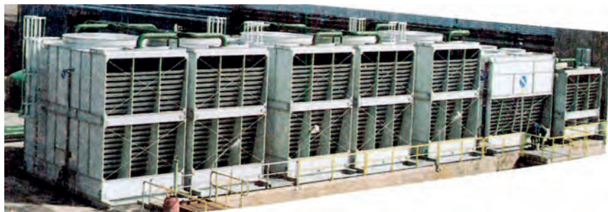
Σχήμα 8-73: Συγκρότημα πύργων ψύξης εγκατάστασης βιομηχανικού κλιματισμού.
