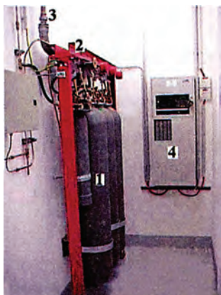
ΣΧ. 10.9α. Σταθμός διοξειδίου του άνθρακα ( \text{CO}_2 ).
