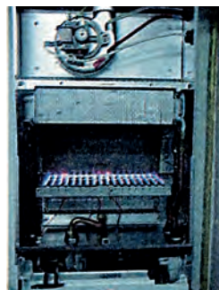
ΣΧ. 4.4γ Επίτοιχος λέβητας αερίου.
