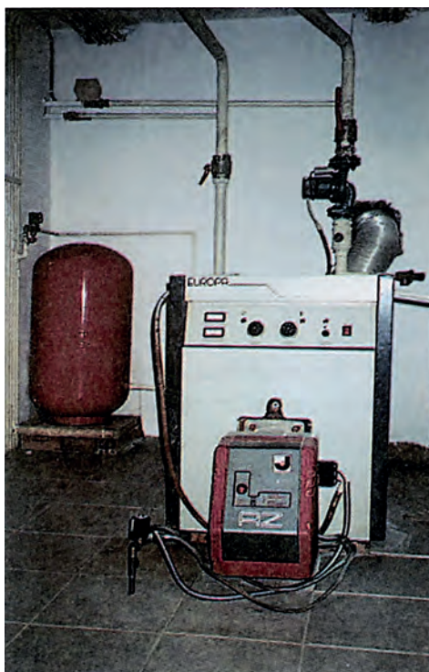
Εικ. (7.1) Λεβητοστάσιο κεντρικής θέρμανσης.
