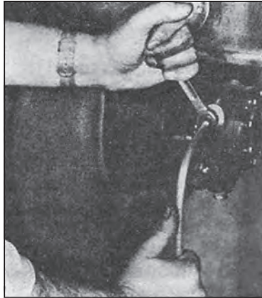
Εικόνα 5 Σφίξιμο των συνδέσμων στο καπάκι της αντλίας.
