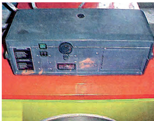
ΣΧ. 4.16.4α Πίνακας αυτοματισμών λέβητα.
