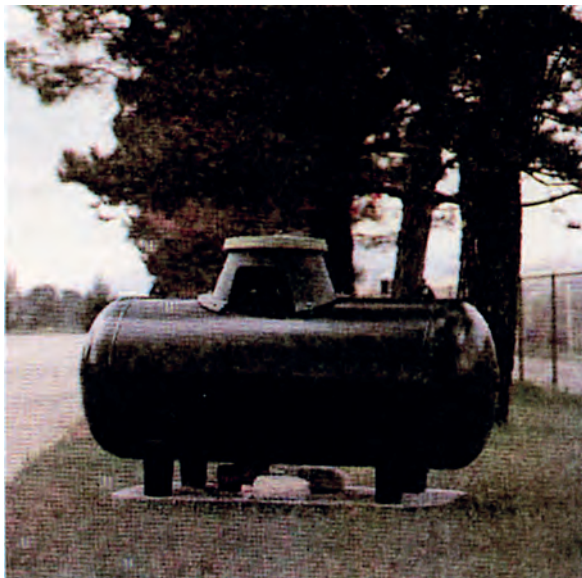
Υπέργεια δεξαμενή υγραερίων
