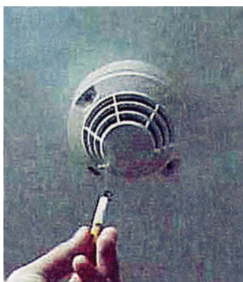
ΣΧ.10.13α Έλεγχος αισθητηρίου με καπνό.
