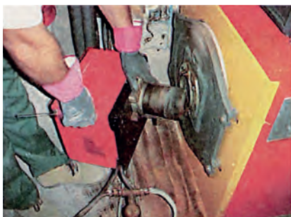
ΣΧ.9.4α Απομάκρυνση καυστήρα από το λέβητα.
