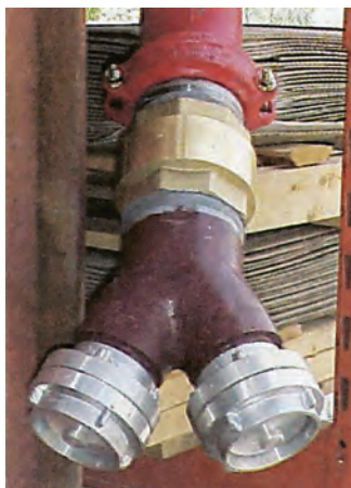
ΣΧ. 10.2.2.α Δίδυμο πυροσβεστικό υδροστόμιο, σε βιομηχανία.
