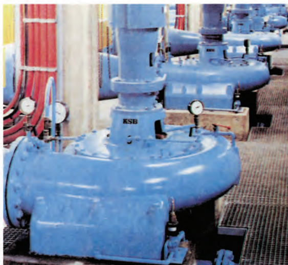
ΣΧ.6.3.α Αντλιοστάσιο ύδρευσης πόλης.
