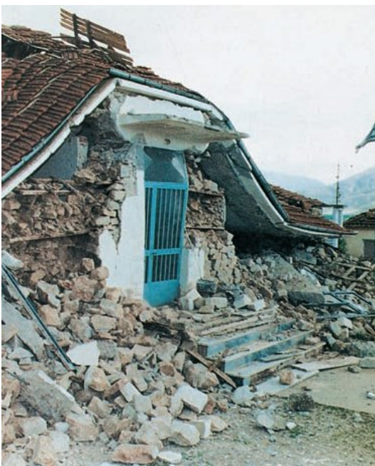
Εικόνα 27.1α: Καταστροφή από σεισμό
