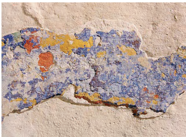
4. Τυχαίος συνδυασμός χρωμάτων που προέρχεται από τους προηγούμενους χρωματισμούς ενός σκασμένου τοίχου.
