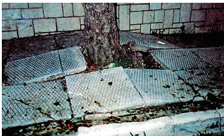
Εικ. 10.7 Πλάκες πεζοδρομίου ανασηκωμένες από δέντρο δεντροστοιχίας
