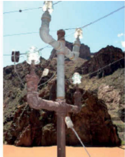
Εικόνα 5.1.α: Εγκατεστημένο τηλεφωνικό δίκτυο
