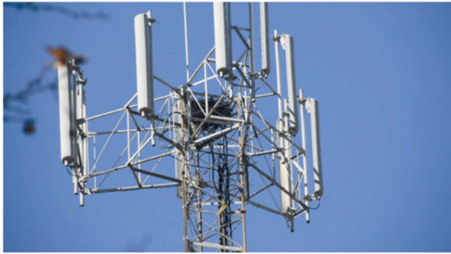
Εικόνα 2.5.β: Κεραία-σταθμός εκπομπής ασύρματου σήματος
