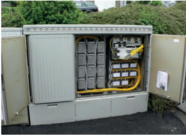
Εικόνα 5.1.4.1.β: Εξωτερικό DSLAM
